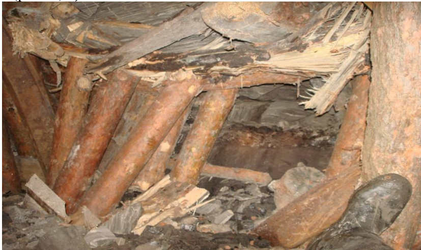
Рис. 3. «Сползание» стоек установленных по бровке
