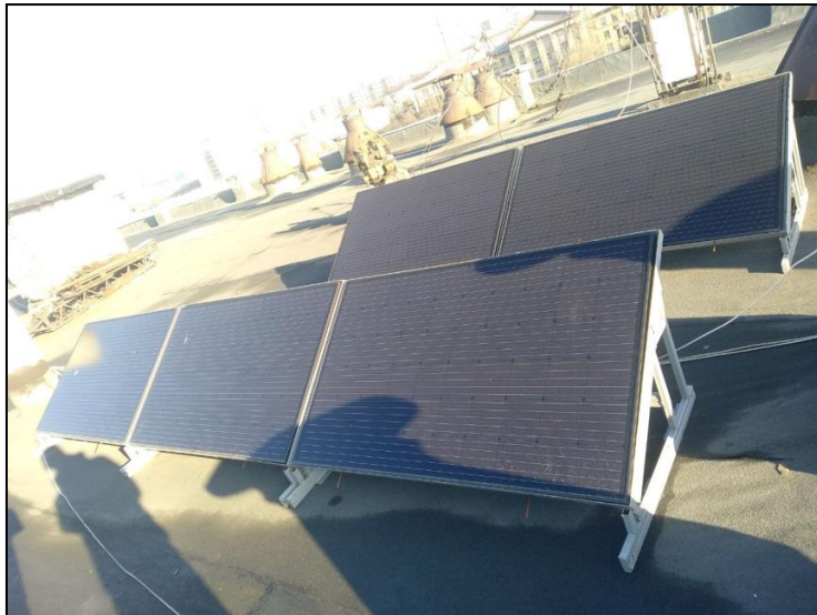
Рисунок 7 – Фото часткового затінення панелей
